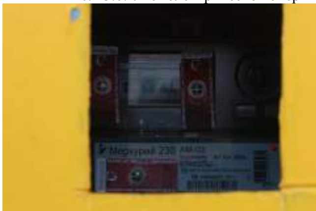
Рис. 23.6. Учёт электрической энергии
