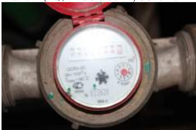
Рис. 2.22. (Подпитка отопления) ОСВУ-40
