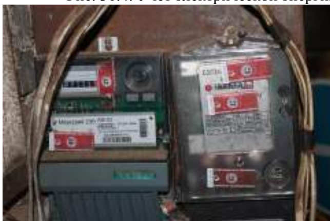
Рис. 30.4. Учёт электрической энергии
