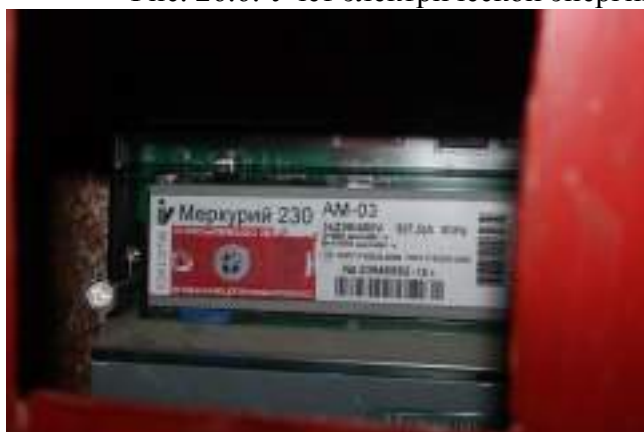
Рис. 26.6. Учёт электрической энергии
