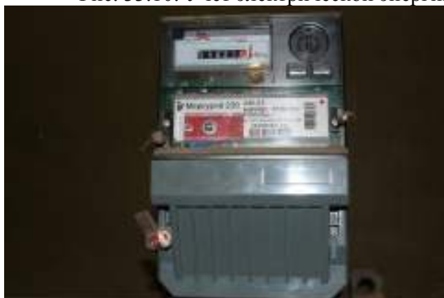
Рис. 33.10. Учёт электрической энергии
