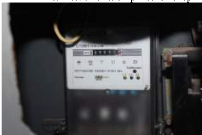
Рис. 24.6. Учёт электрической энергии
