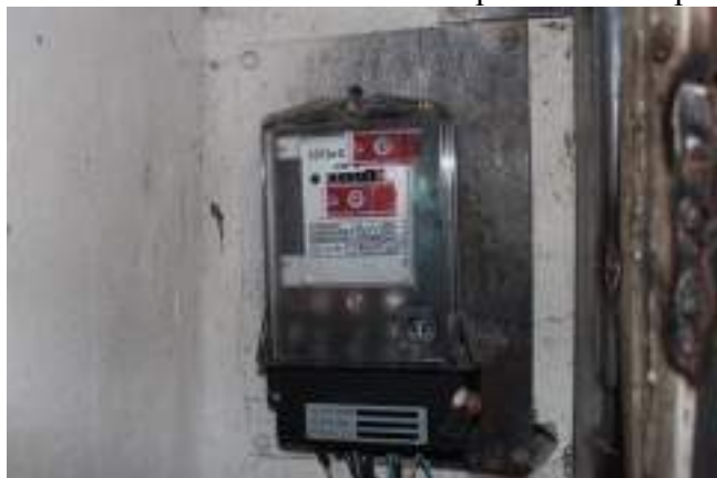
Рис. 3.17. Учёт электрической энергии
