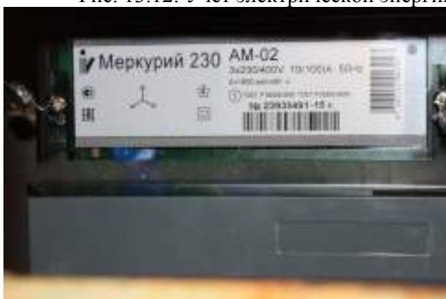
Рис. 13.12. Учёт электрической энергии
