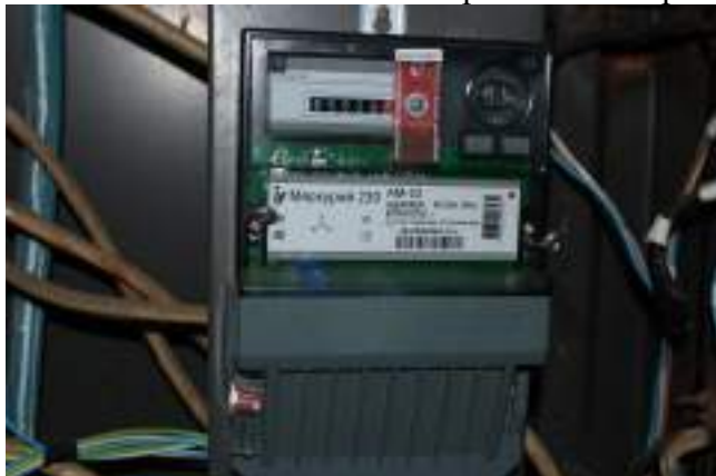
Рис. 21.5. Учёт электрической энергии
