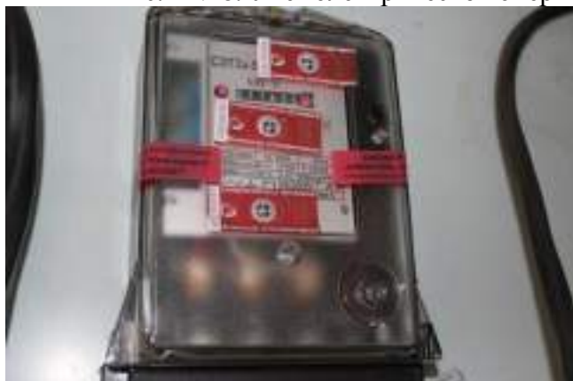
Рис. 14.18. Учёт электрической энергии
