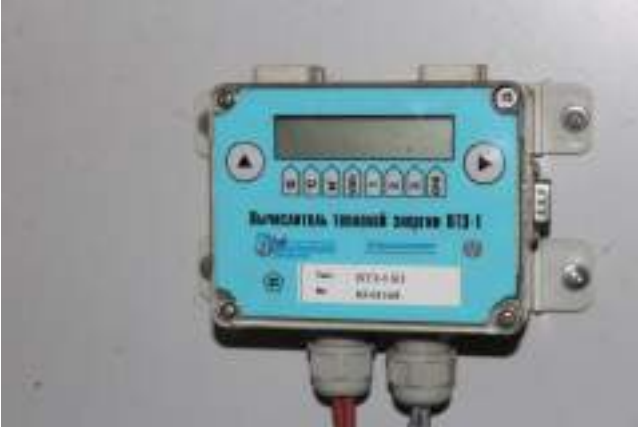
Рис. 1.8. Учёт тепловой энергии 1 шт.
