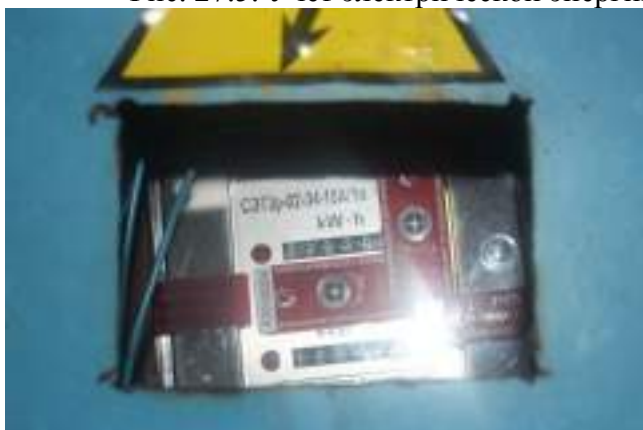
Рис. 27.5. Учёт электрической энергии
