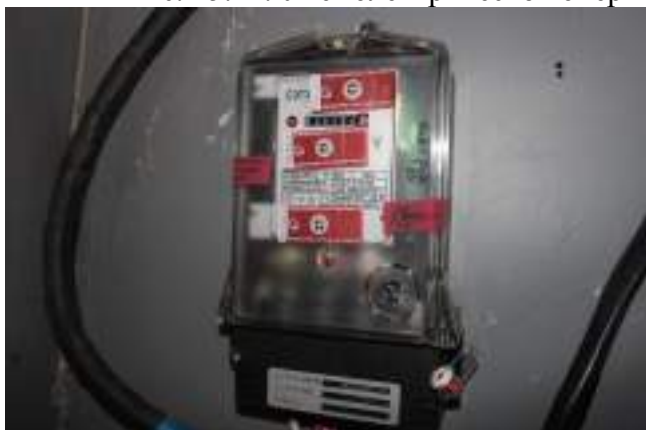
Рис. 15.11. Учёт электрической энергии
