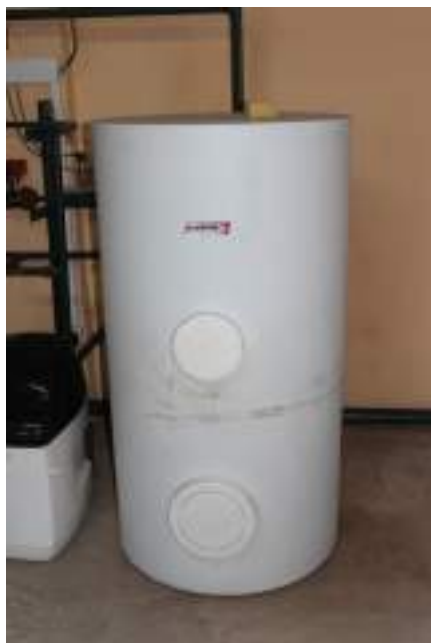
Бак аккумулятор (ГВС)
