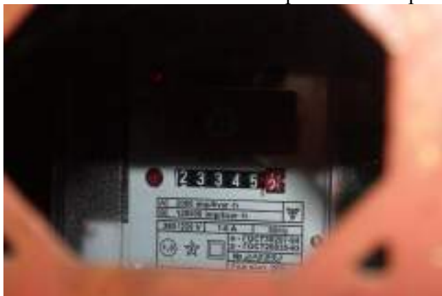
Рис. 22.5. Учёт электрической энергии
