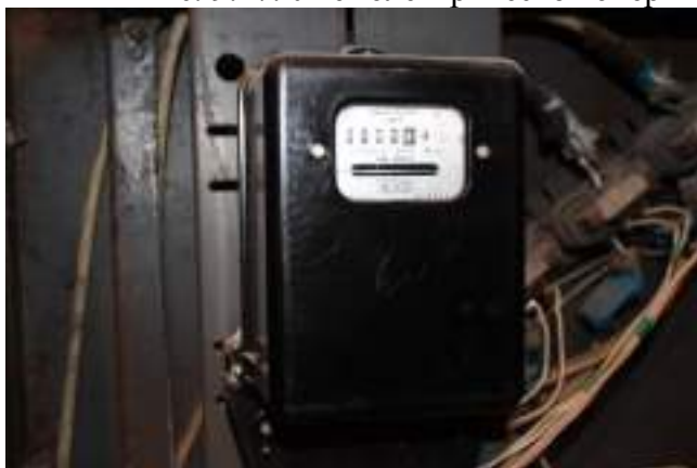
Рис. 9.17. Учёт электрической энергии
