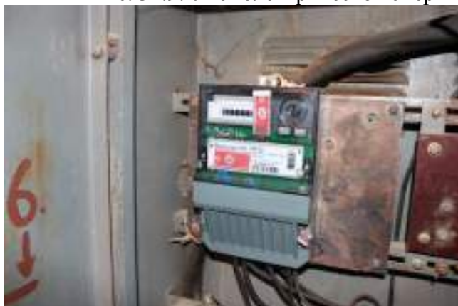
Рис. 31.9. Учёт электрической энергии
