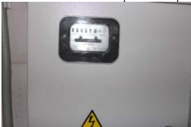
Рис. 31.5. Учёт электрической энергии
