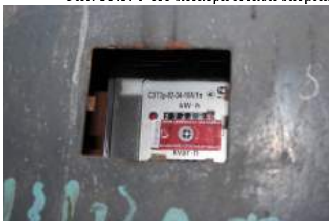
Рис. 35.5. Учёт электрической энергии
