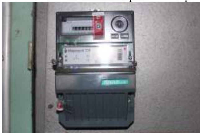
Рис. 5.14. Учёт электрической энергии
