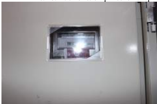
Рис. 18.11. Учёт электрической энергии
