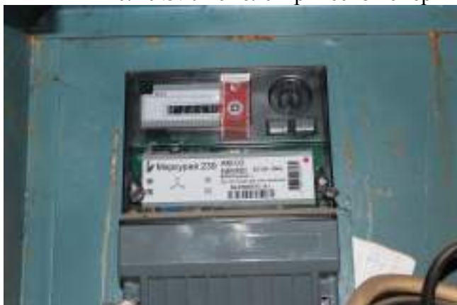
Рис. 29.5. Учёт электрической энергии
