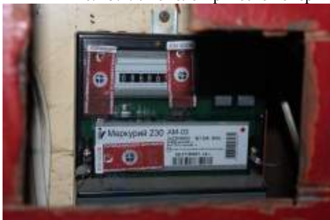
Рис. 25.4. Учёт электрической энергии
