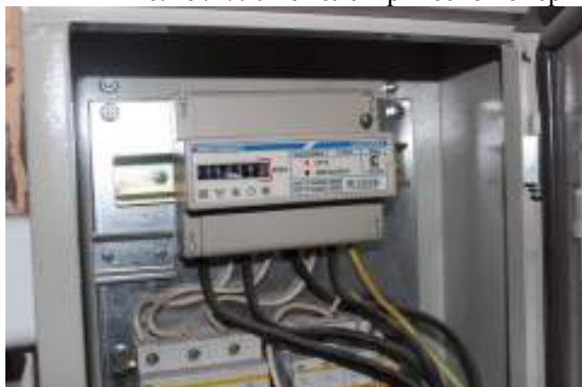
Рис. 19.17. Учёт электрической энергии
