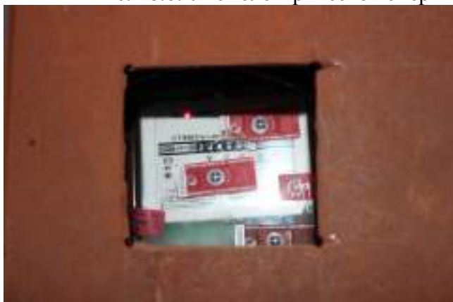
Рис. 28.6. Учёт электрической энергии
